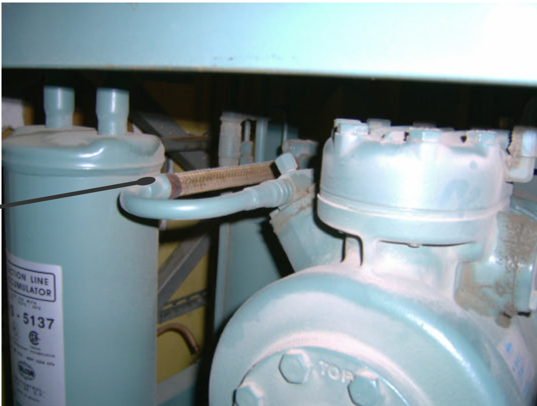
Monteringsplats för givare, sett från sidan.
